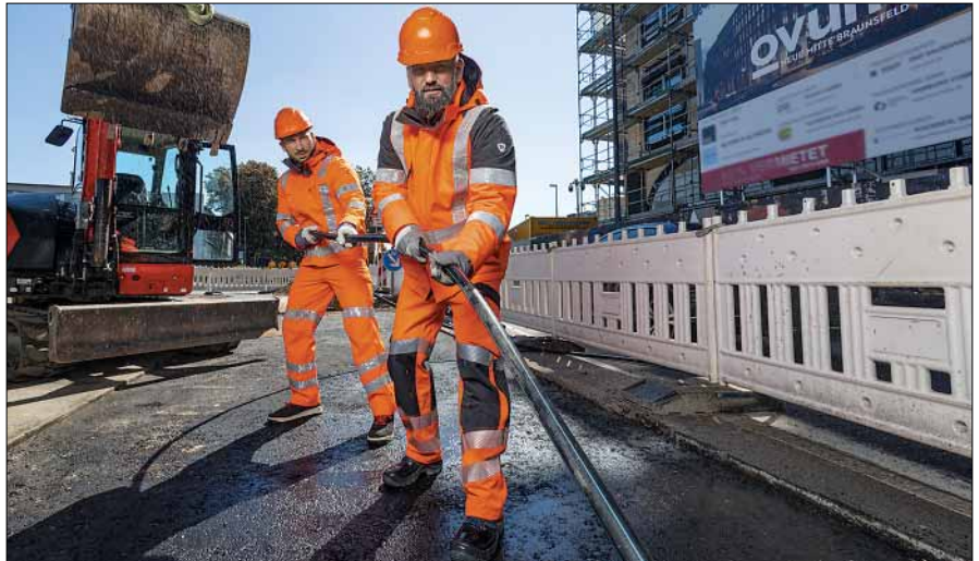
All jene, die Fahrbahnen reparieren, Leitungen verlegen, Gleise kontrollieren oder den Abfall entsorgen, sind mit der Kollektion BP Hi-Vis Stretch bestens ausgestattet.
