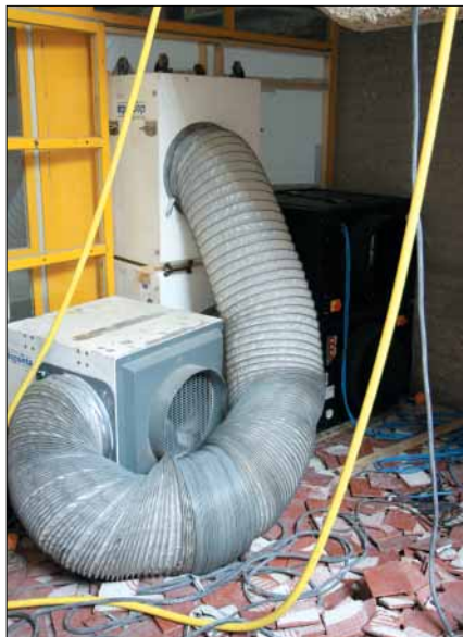
Speziallüfter sorgen für Unterdruck in den »Schwarzbereichen«.
