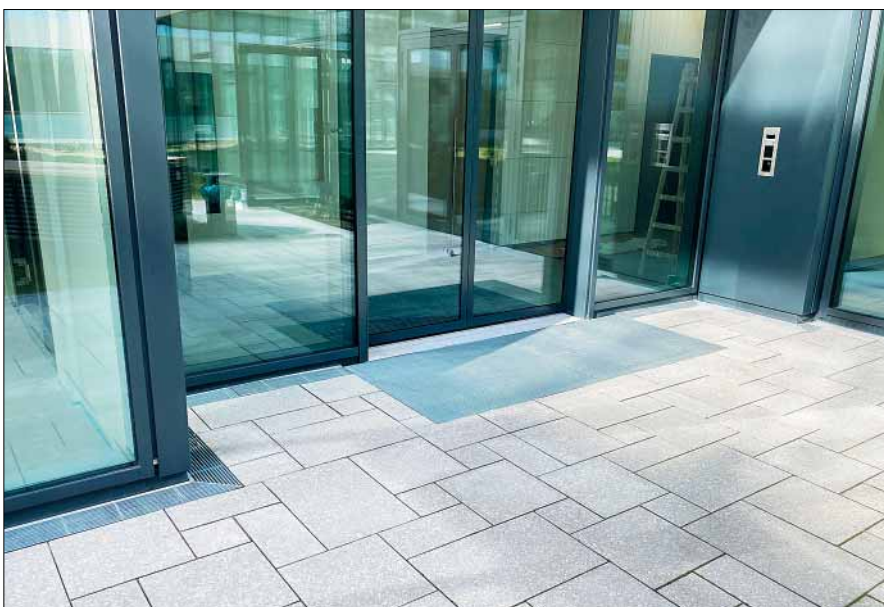
Eingangsbereiche werden in die Fassadenentwässerung eingebunden.
