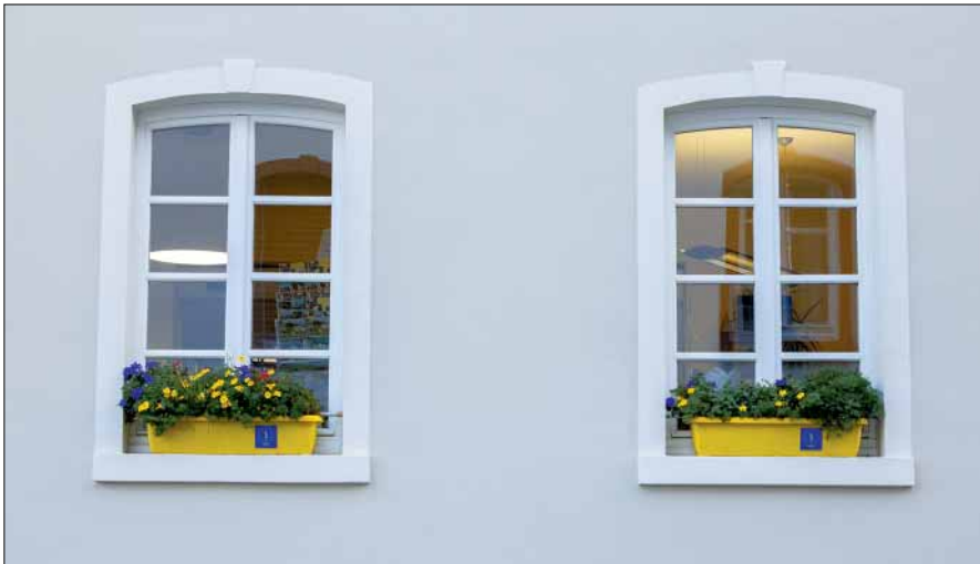
Kleine Risse und Abplatzungen hat das Team um Maler Berger mit Alligator Kieselit Streichvlies ausgeglichen. Nach dem Anstrich mit Alligator Kieselit Fusion zeigt sich nun eine makellose Oberfläche.
