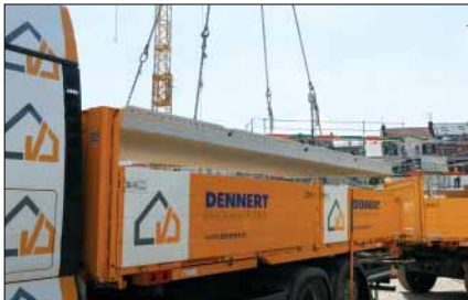
Die Deckenelemente werden zum größten Teil im Werk vorgefertigt und als trockenes Bauteil per Lkw angeliefert.
