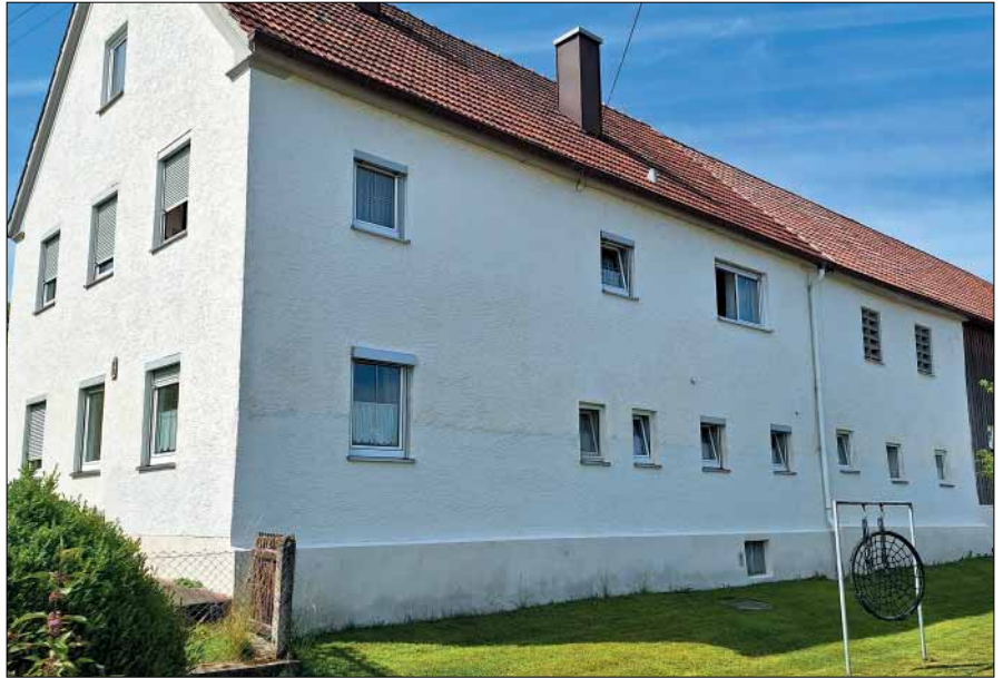
Ehemals landwirtschaftlich genutzte Gebäude bieten Potenzial für die Schaffung neuen Wohnraums. Doch viele dieser Altgebäude leiden durch teils jahrelangen Leerstand unter feuchten Mauern.
